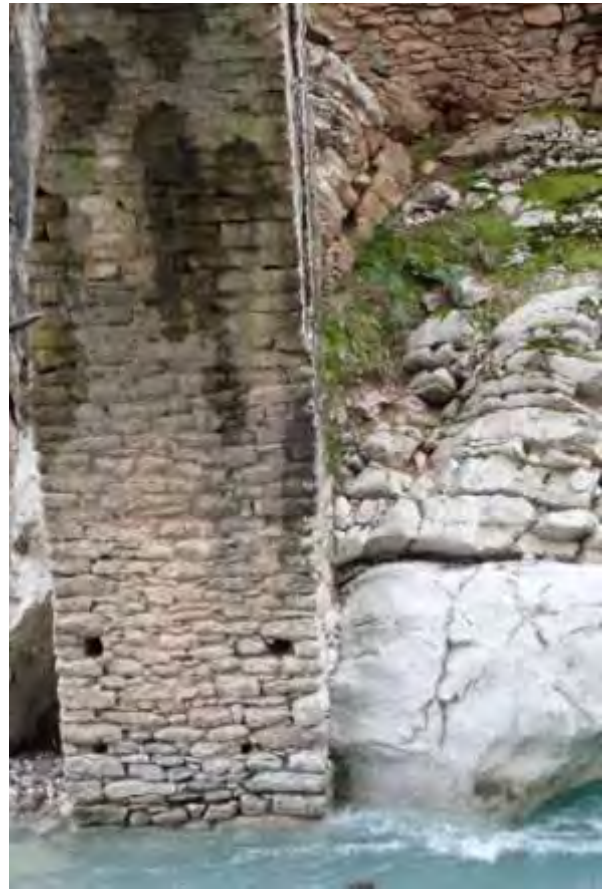
Ρηγματώσεις και πιθανή καθίζηση στη βάση
