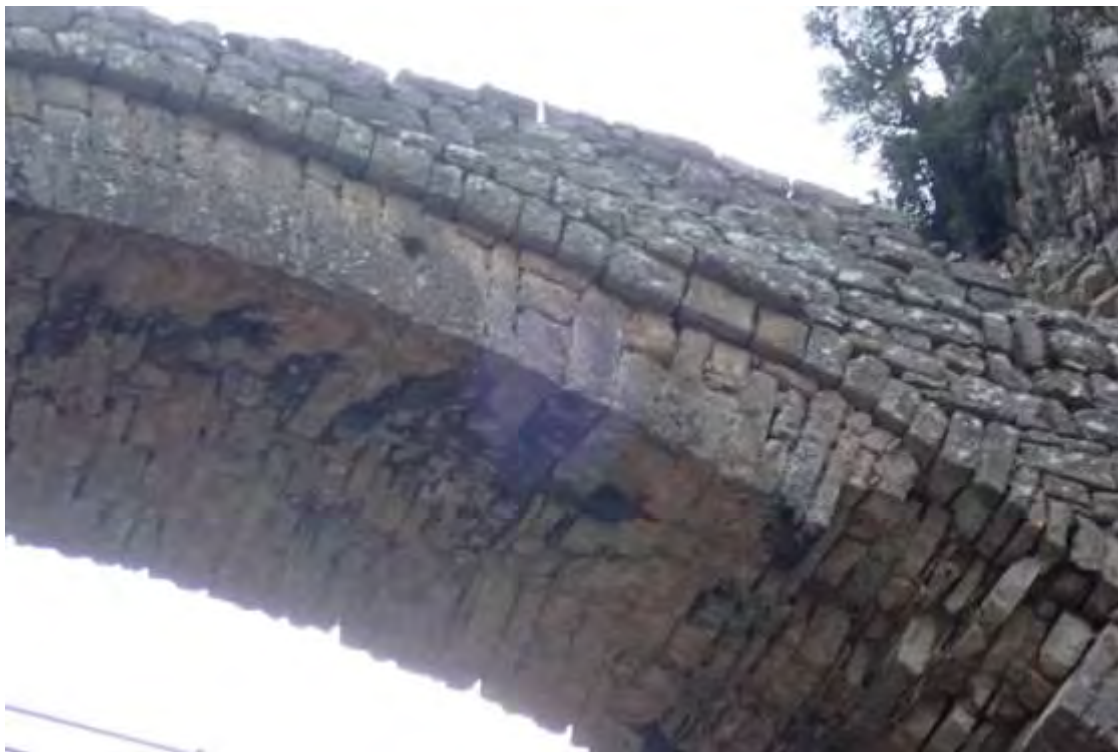
Λεπτομέρεια της απόπλυσης του κονιάματος, των ρηγματώσεων και της αποκόλλησης των λίθων μετώπου και θολιτών
