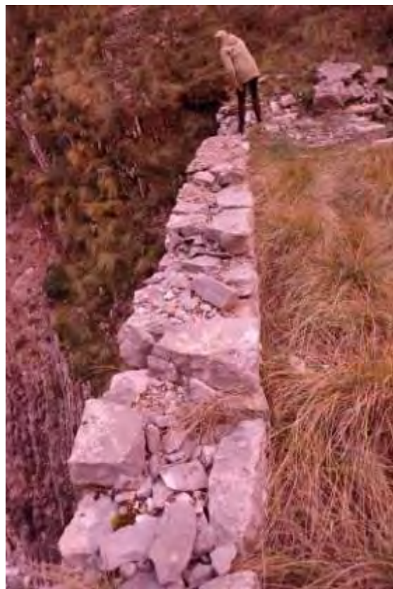
Κατάσταση διατήρησης στηθαίου
