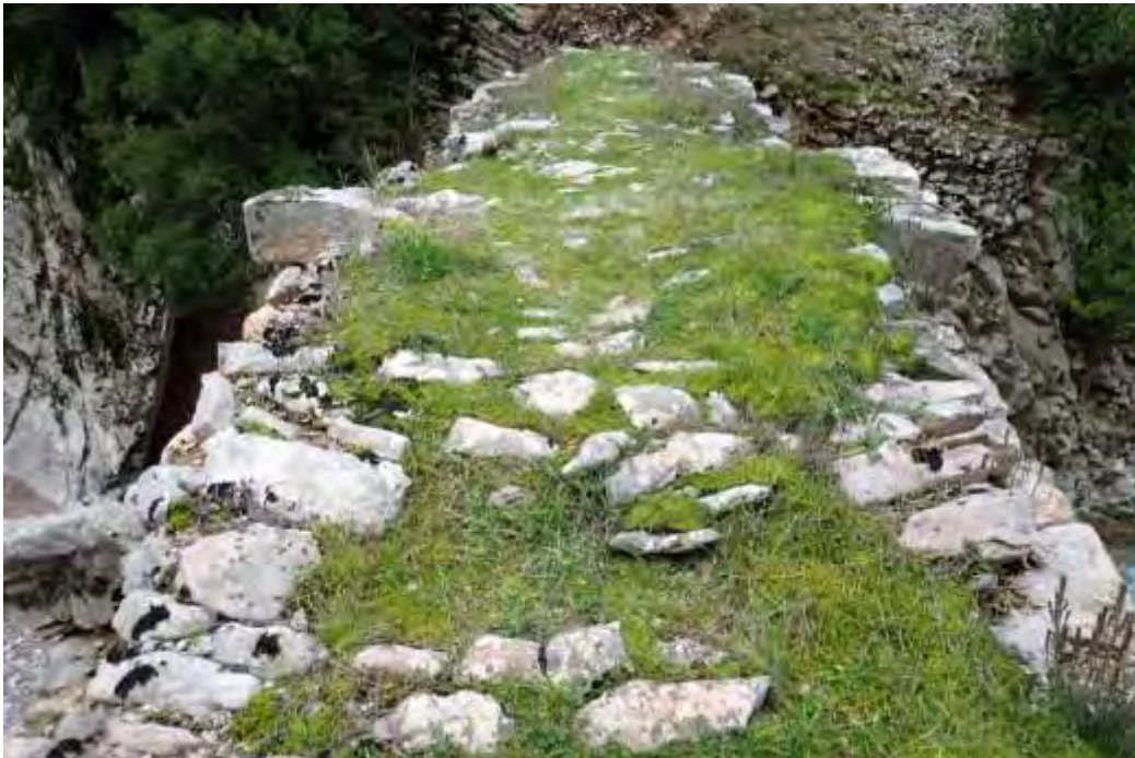
Ανάπτυξη βλάστησης στο κατάστρωμα της γέφυρας
