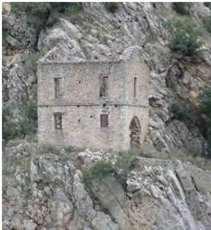
Η εναπομείνασα «Κούλια» πάνω σε σχιστολιθικό σχηματισμό – διακρίνονται ρηγματώσεις οι οποίες πιθανώς να επιβαρύνουν την έδραση του φυλακίου
