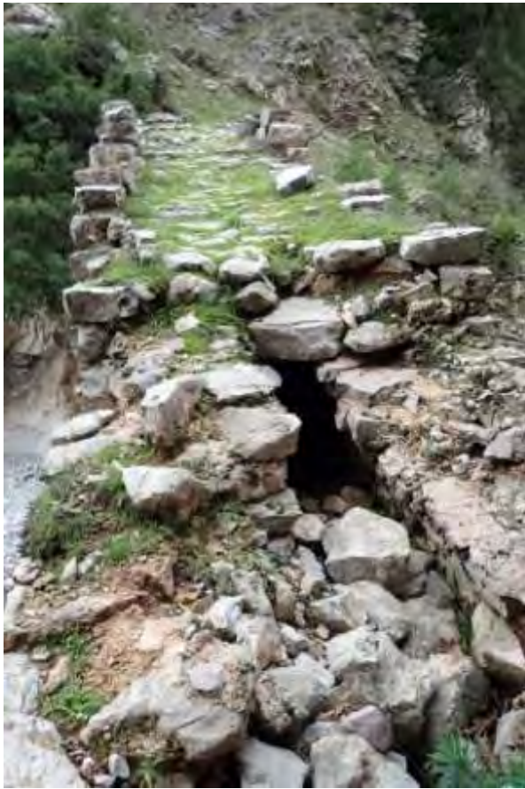
Λαθροθηρική αποδόμηση στη βάση της γέφυρας και εις βάθος
