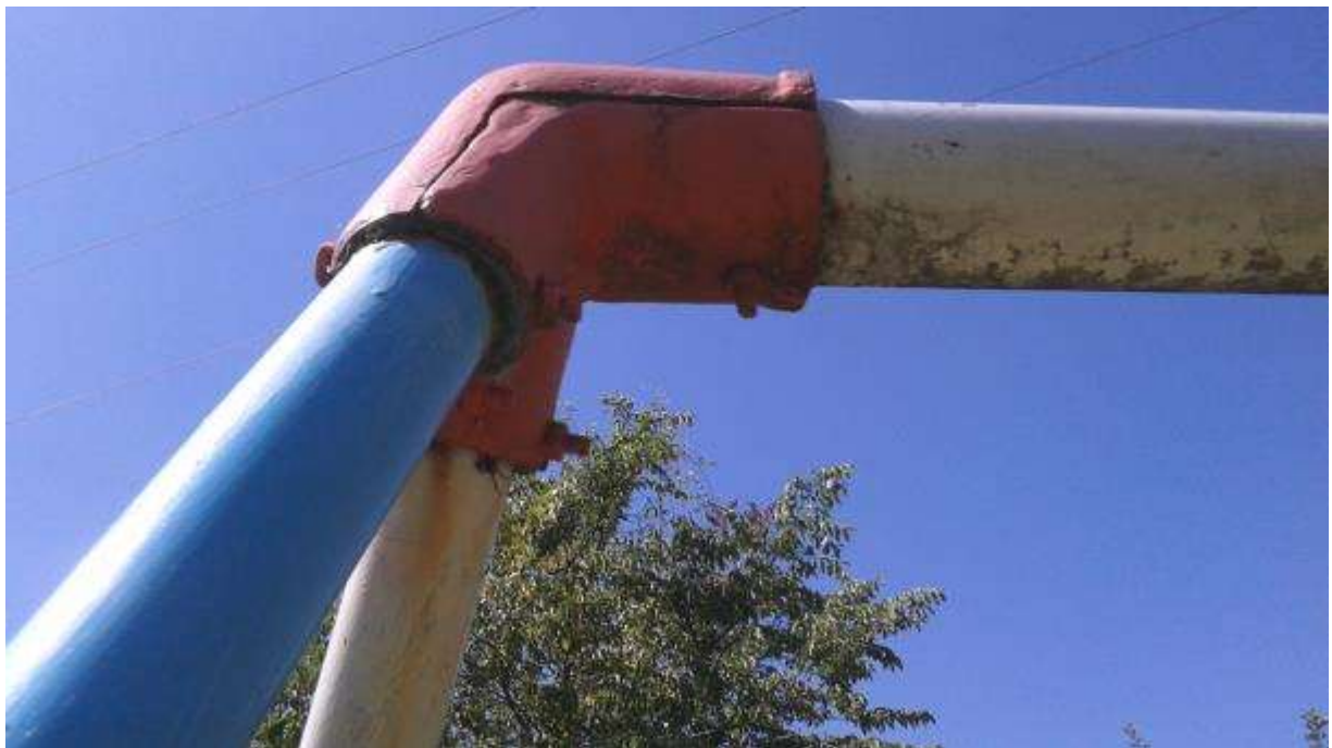
Εικόνα 10: Ακάλυπτες βίδες στον σκελετό της κούνιας Νο1.
